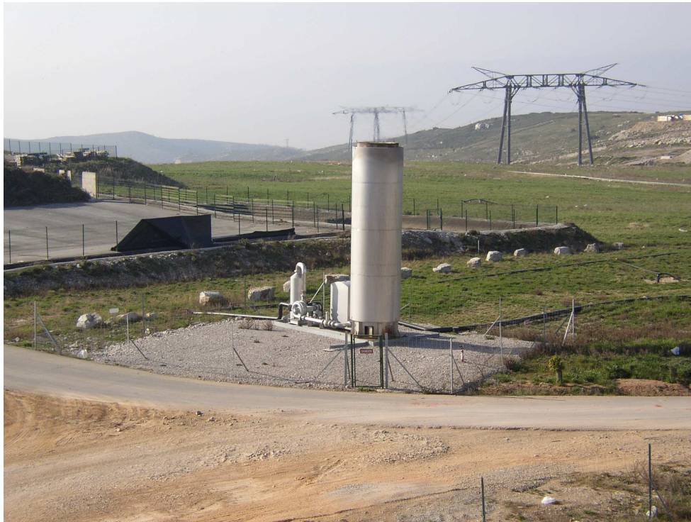
Photo 1 : Nouvelle torchère mise en place (2000 m 3 /h)
